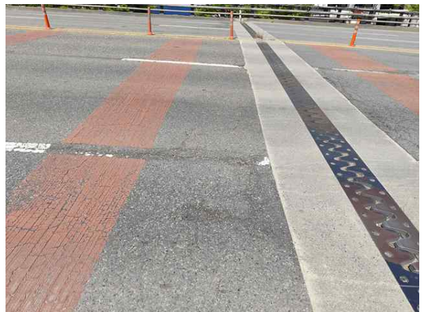
S5 아스콘 망상균열 및 열화
