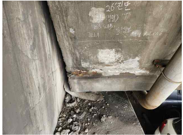
S5-A2 거더복부 박락 및 철근노출
