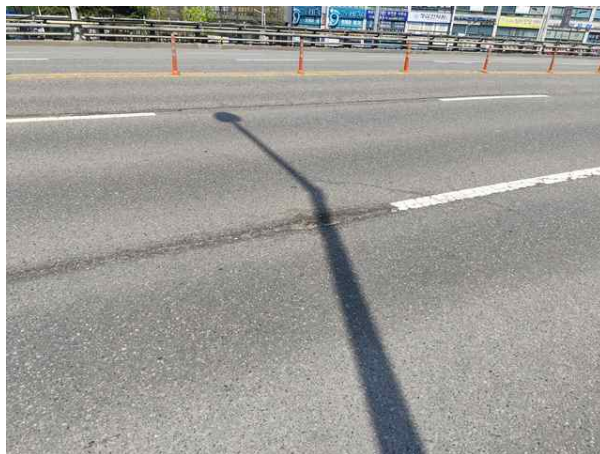
S3 아스콘 탈락
