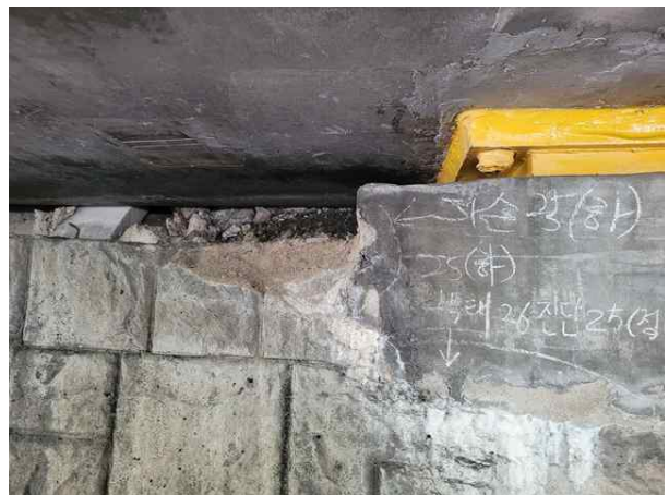
A1 구체 콘크리트 파손
